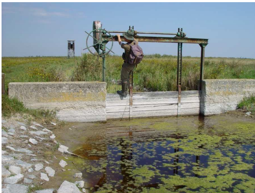
Abb. 69. Nicht funktionierende Wehranlage am Xigsee (Foto: Korner, 2008).
